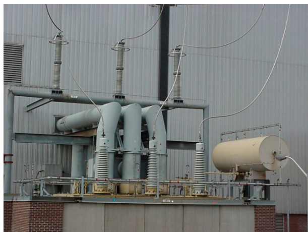
Fot. 1. Wyprowadzenie mocy generatora do transformatora blokowego trójfazowego w elektrowni Pickering (fot. za zgodą OPG 2007) Photo 1. Main Output Transformer Isolated Phase Bus (IPB) at Pickering NGS (Picture courtesy of OPG 2007)
