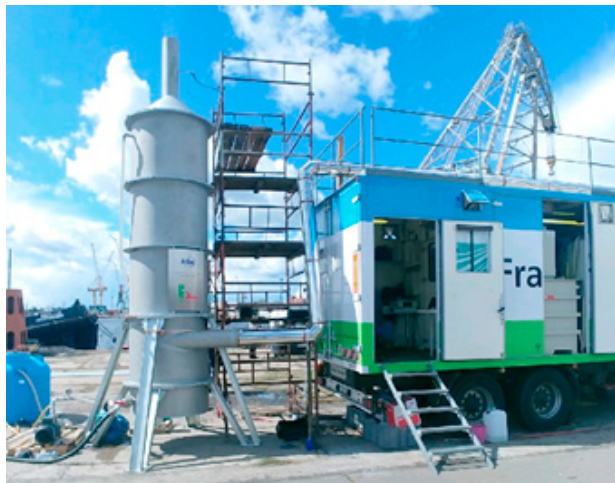
Fot. 1. Na zdjęciu instalacja do oczyszczania gazów spalinowych przy użyciu wiązki elektronów z okrętowego silnika diesla zbudowana w Stoczni Remontowej w Rydze, Łotwa
